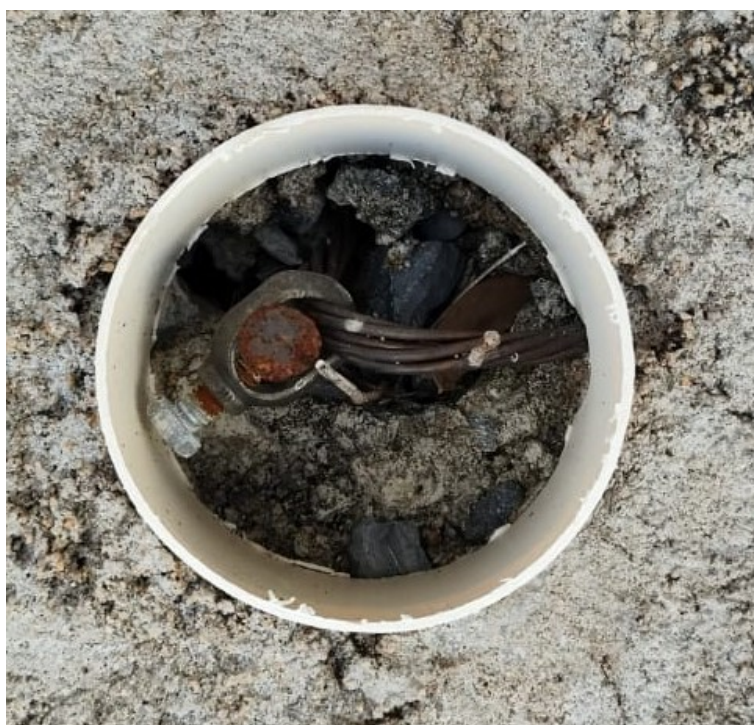
Figura 76 - Haste de aterramento - Reservatório Califórnia
