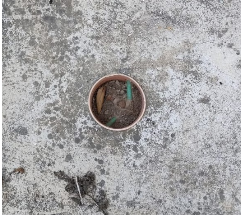
Figura 11 - Ponto de aterramento e visita SPDA - Reservatório Mata Cavalo
