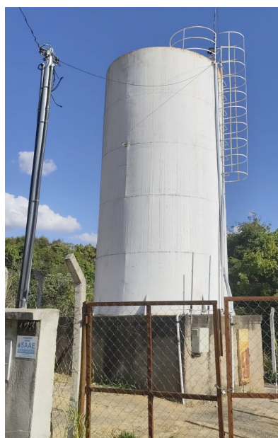
Figura 65 - Reservatório Alto do Pequi (Santana)
