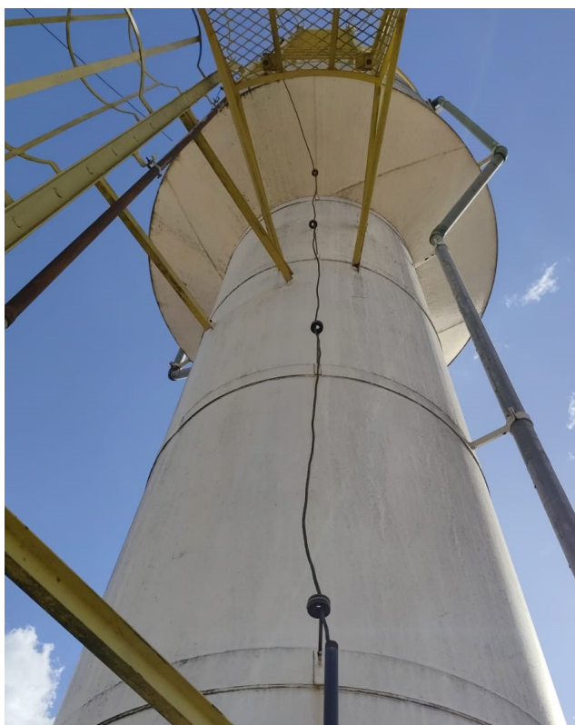
Figura 60 – Descida de de aterramento - Reservatório Residencial D'Carlos
