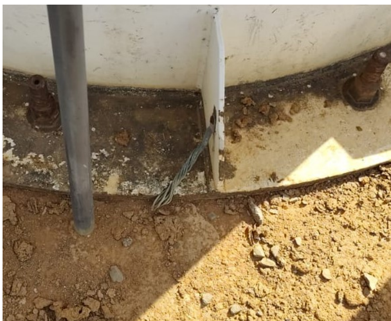
Figura 61 - Conexão da base do reservatório a malha de aterramento - Reservatório Residencial D'Carlos
