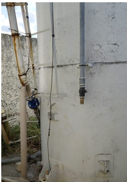
Figura 45 - SPDA precário - Reservatório Tino Pereira
