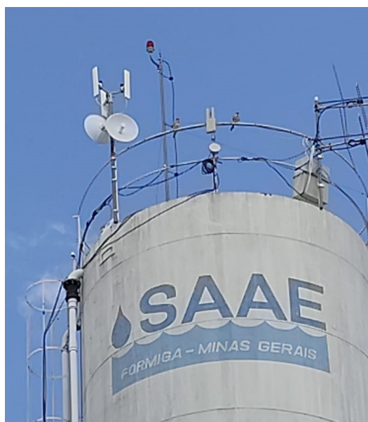
Figura 21 - Captor tipo Franklin - Reservatório Nossa Senhora de Lourdes
