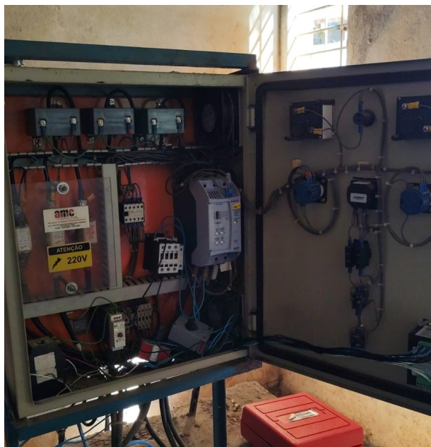
Figura 18 - Quadro de comando 1 - Reservatório Rosário
