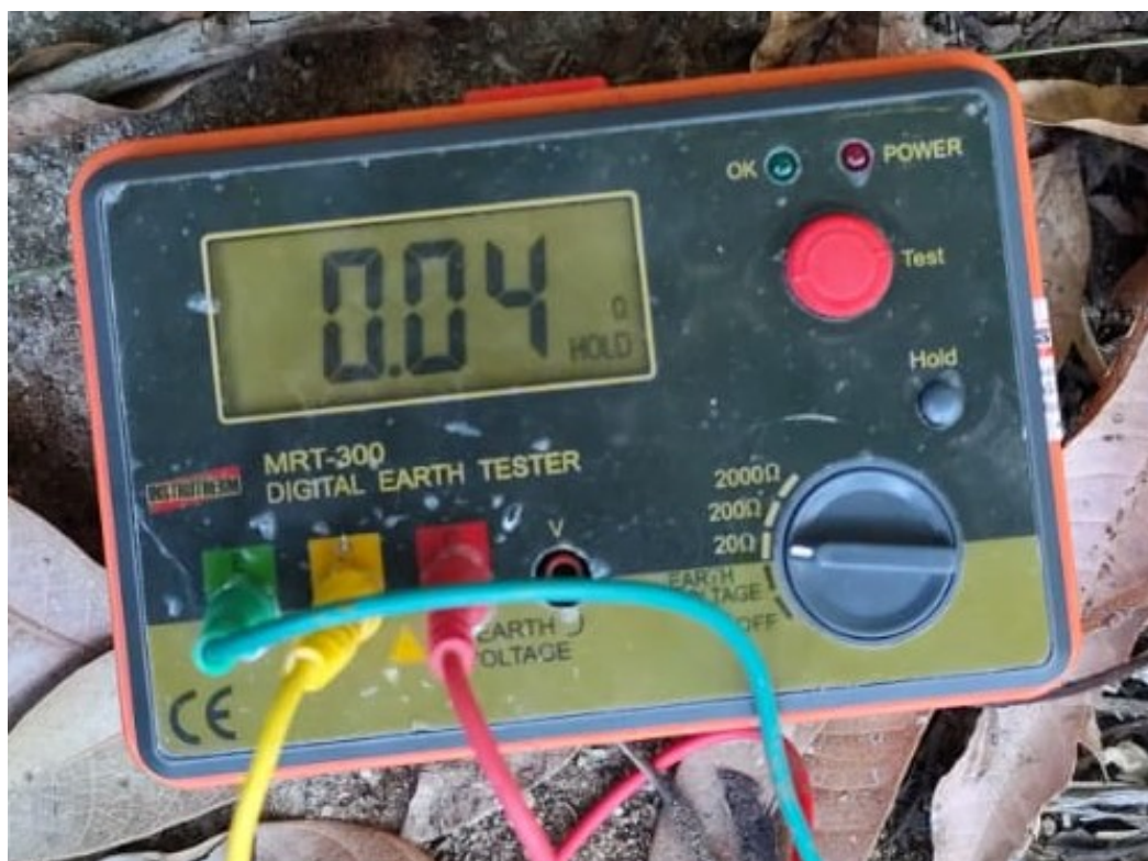
Figura 16 - Medição de sistema de aterramento dos quadros elétricos - Reservatório Mata Cavalo
