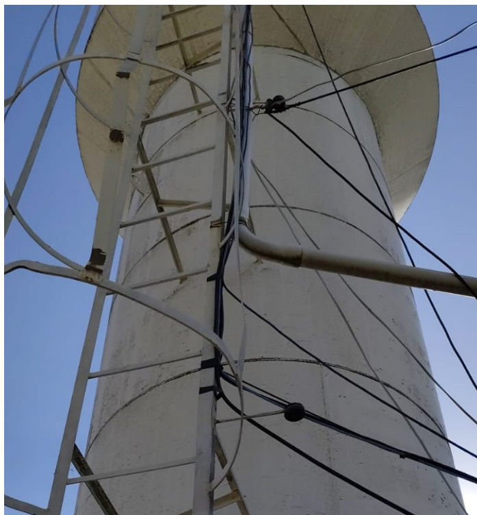
Figura 36 - Olhal de Descidas do Reservatório sem cabeamento - Reservatório Novo Horizonte
