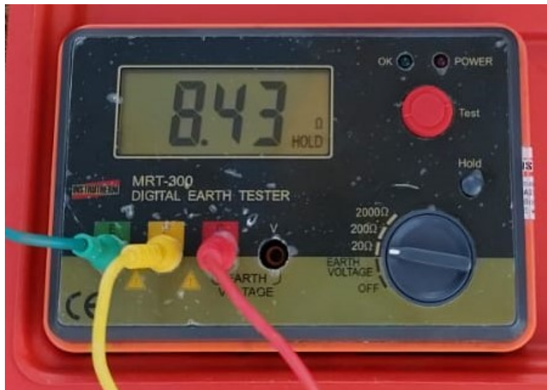
Figura 62 - Medição de Resistividade do sistema de SPDA - Reservatório D'Carlos
