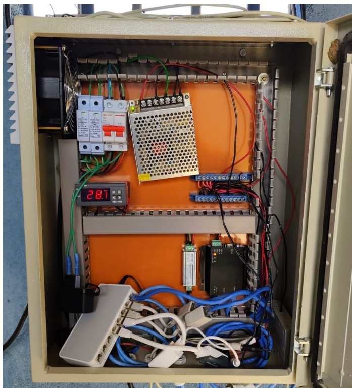
Figura 37 - Quadro de Telemetria - Reservatório Novo Horizonte
