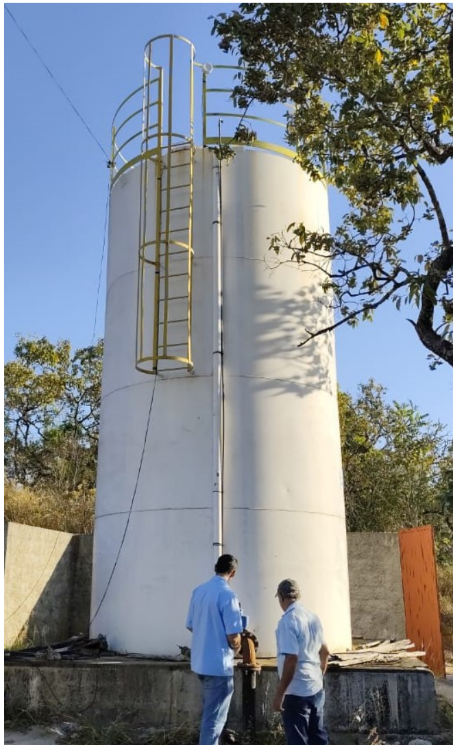
Figura 72 - Reservatório Alto dos Pinheiros II
