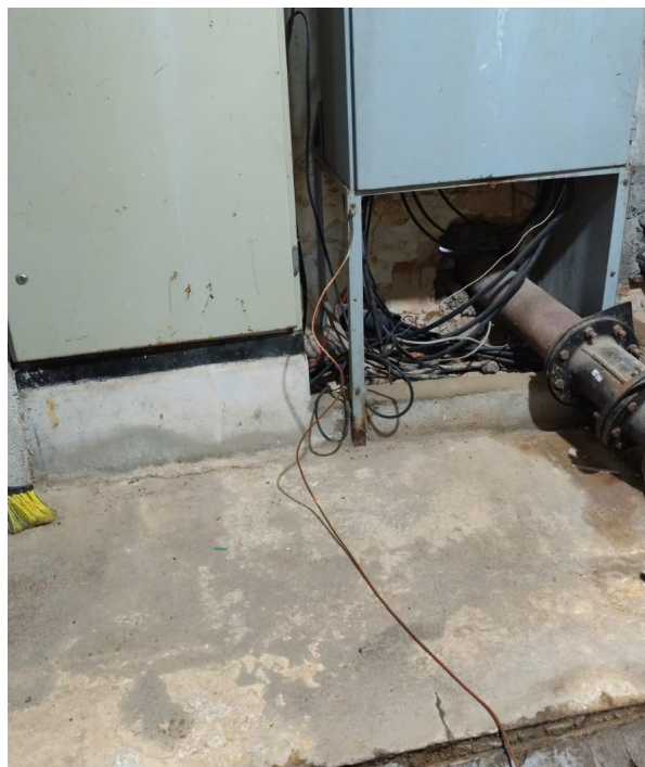
Figura 14 - Quadro aterrados em cabos expostos - Reservatório Mata Cavalo
