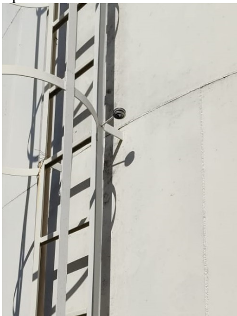
Figura 27 - Olhal de descida do SPDA sem cabos - Reservatório Picolé
