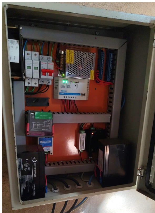
Figura 19 - Quadro de comando 2 - Reservatório Rosário
