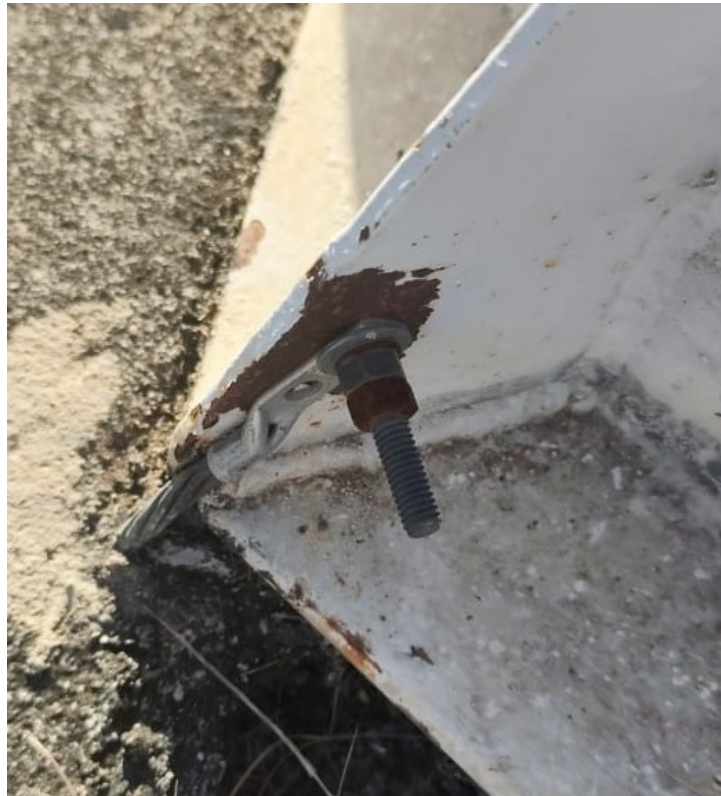
Figura 70 - Conexão de base de estrutura a malha de aterramento - Reservatório Alto dos Pinheiros I
