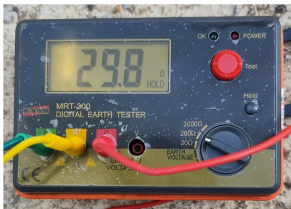
Figura 47 - Medição de resistividade de SPDA - Reservatório Tino Pereira
