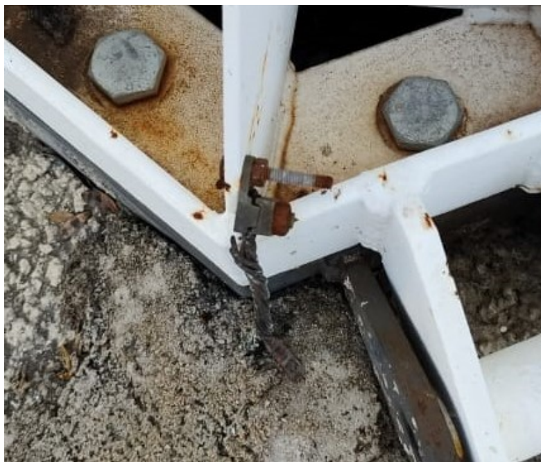
Figura 75 - Conexão das estruturas da base ao aterramento - Reservatório Califórnia
