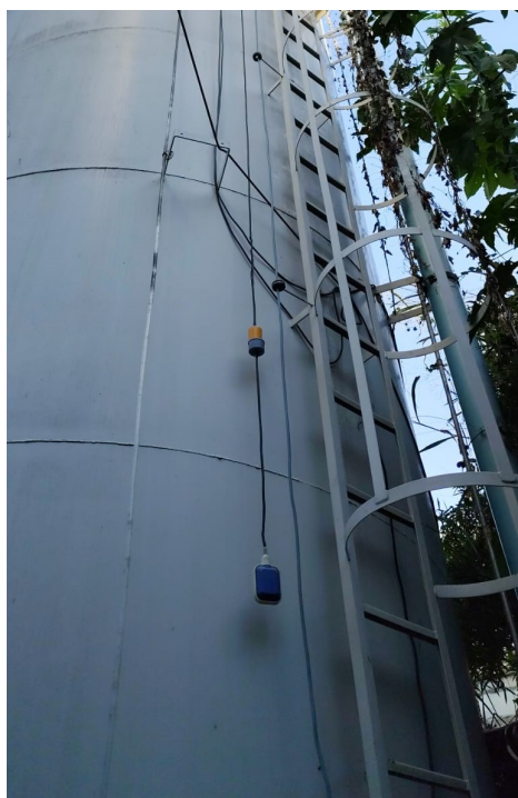
Figura 10 - Descida de SPDA - Reservatório Mata Cavalo
